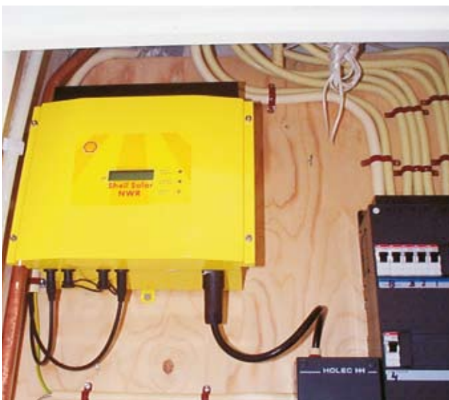
De gele kast is de omvormer zelf, rechts in de meterkast bevindt zich de (zwarte) groepenkast
