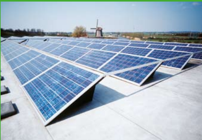
Zonnepanelen op platte daken: Besseling, Alkmaar
